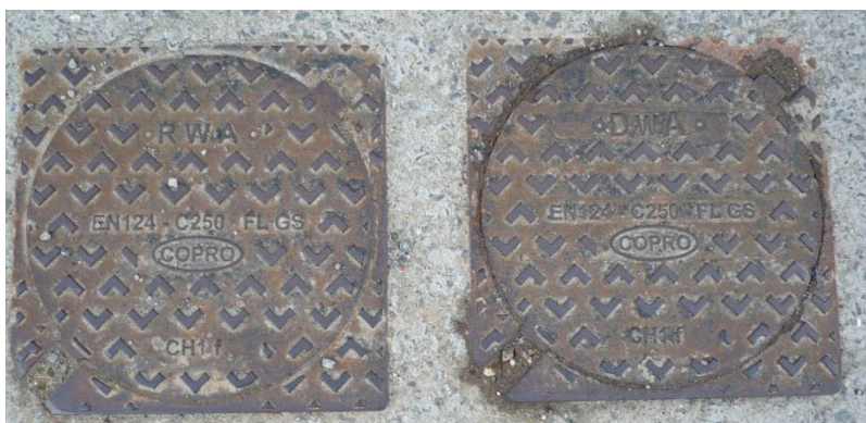
Aansluitputjes RWA en DWA door de rioolbeheerder geplaatst (voorbeeld)
